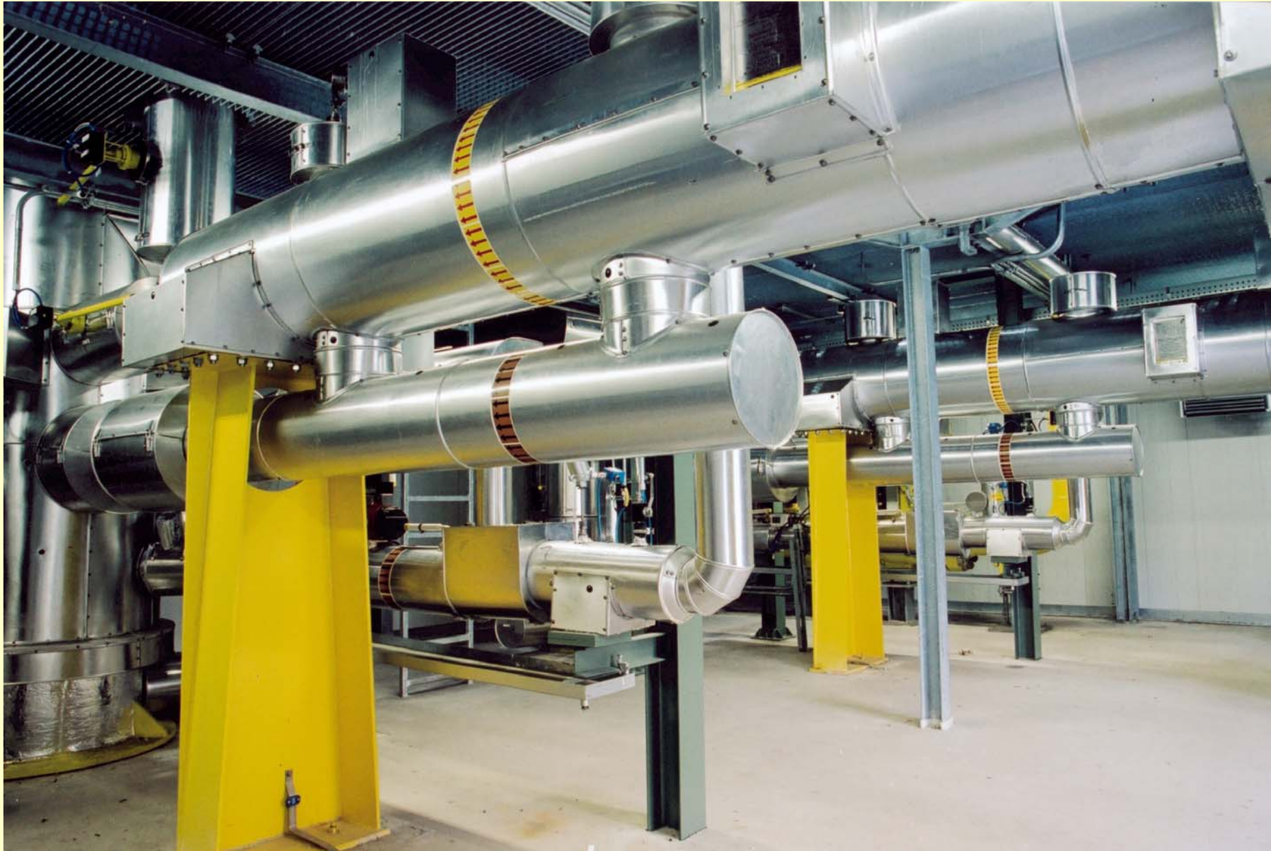
Wirbelrohranlage Erdgastrocknung, Thyssengas GmbH, 40.000 Nm 3 /h
